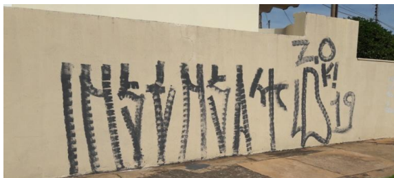
Figura 1: Pixação em parede residencial, localizada da Avenida Júlio de Castilho 175 .
